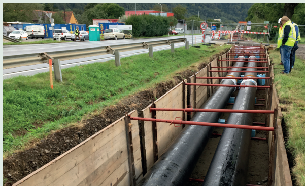
Foto: Bioenergie Fernwärme/Mag. Jakob Edler
